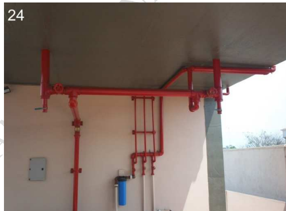
24: Vista de las bajadas desde el tanque de agua. El artefacto azul es un filtro con destino exclusivo para abastecer a los boxes odontológicos.
