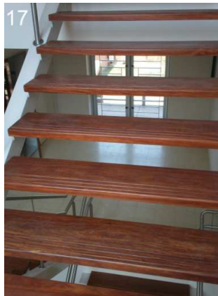
17: Detalle de los escalones de la misma escalera con tratamiento antideslizante.
