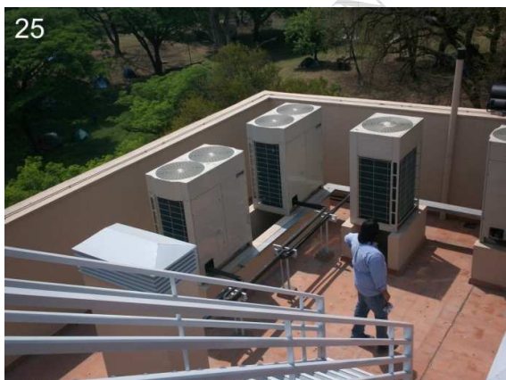
25: Vista de las torres de enfriamiento de los equipos de aire acondicionado.
