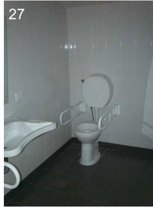
27: Detalle del sector del inodoro con barrales móviles de los dos lados.
